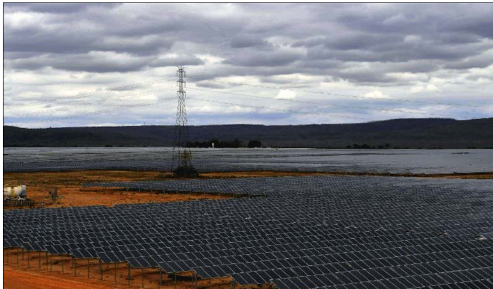
Usina Solar em Pirapora-MG
